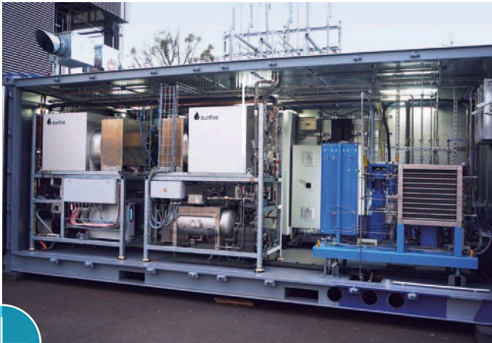
In Duisburg wurde der Kompressor in die Infrastruktur eines Forschungsinstituts integriert.
